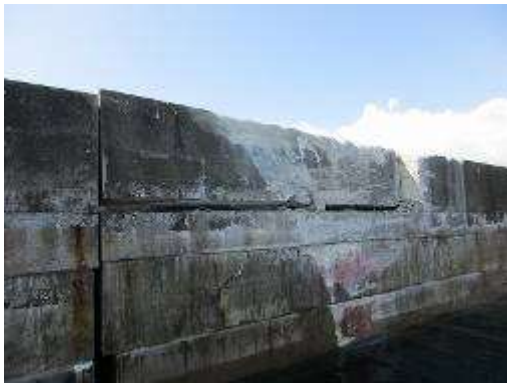
写真 2.4-2 パラペット等の損傷状況
