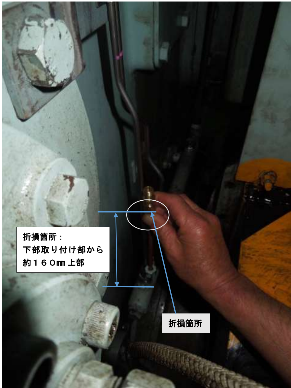
写真1 火災発生時の本件パイプ折損箇所
