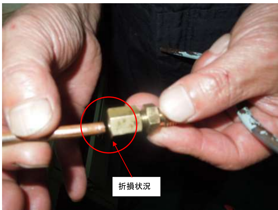
写真2 火災発生時の本件パイプ折損状況
