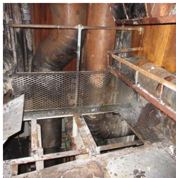
写真8 機関室上段 (船首側から)
