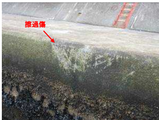
写真1 西宮防波堤の損傷状況
