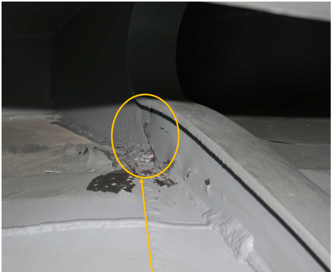
内側から見た亀裂
