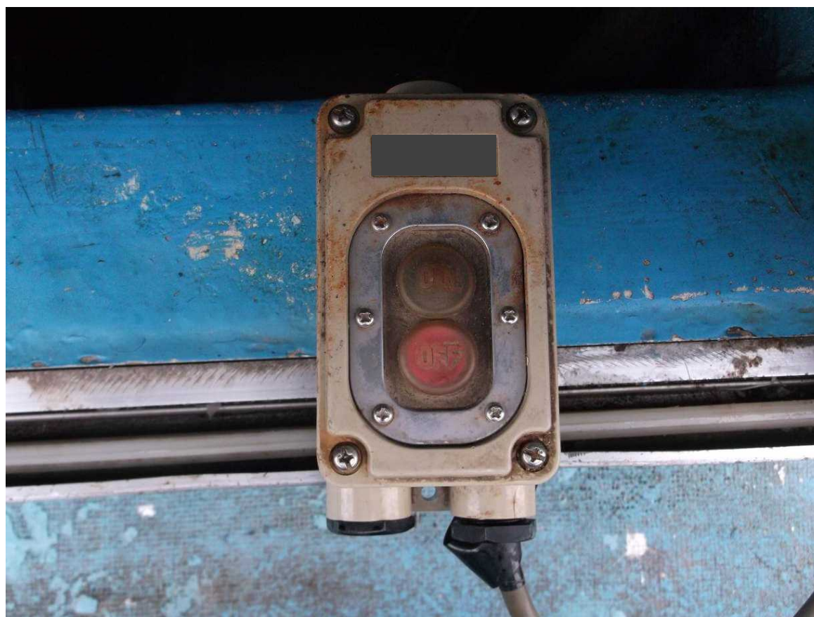
写真2 遠隔操縦用押しボタンスイッチ
