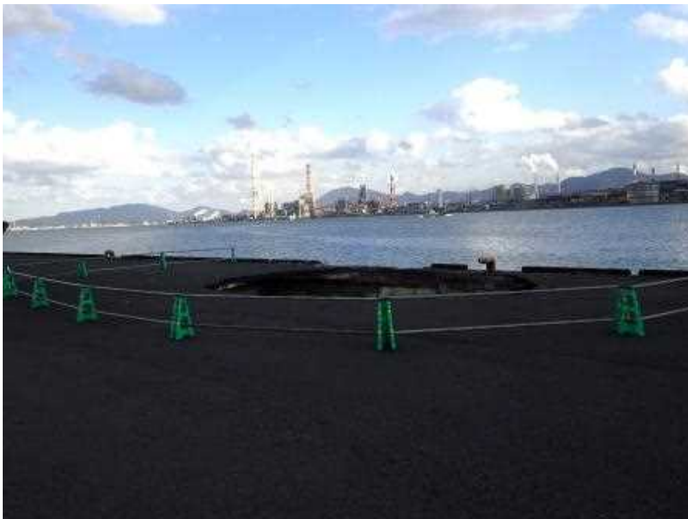
写真2 岸壁舗装面の陥没
