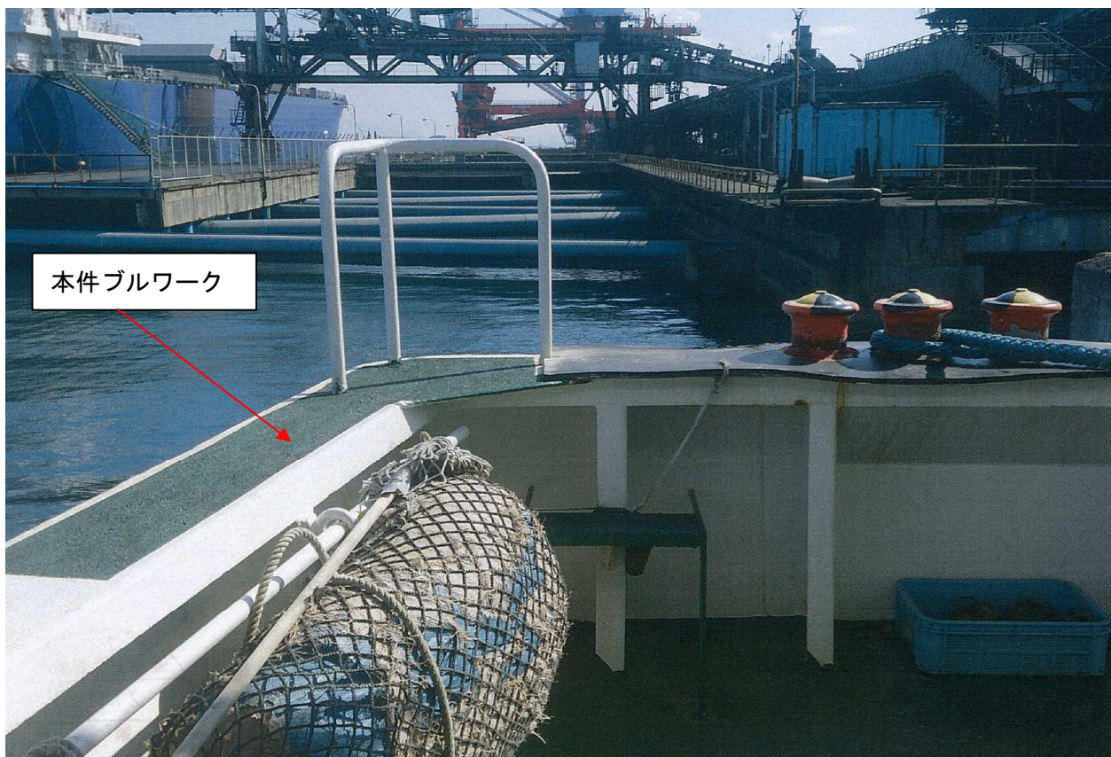
写真1 本件ブルワークの状況（右舷船首から右舷船尾を見たところ）
