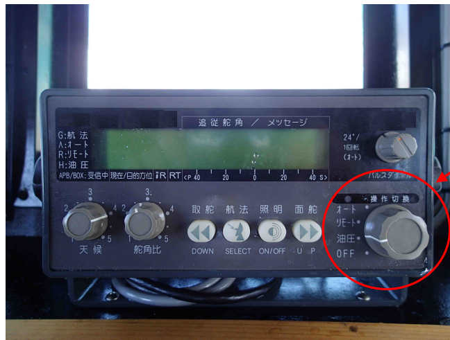
写真2 操舵装置制御盤
