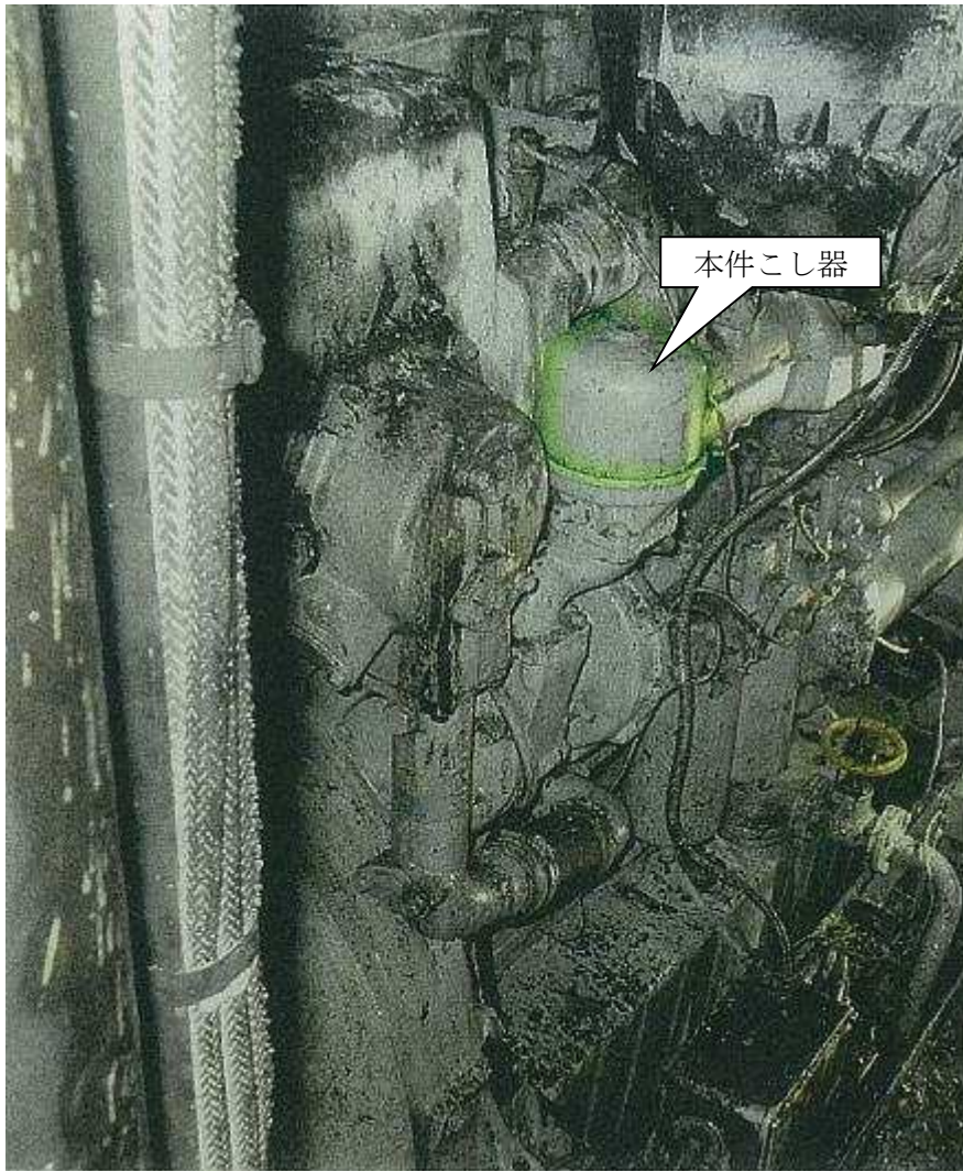
写真2 焼損した本件こし器付近の状況
