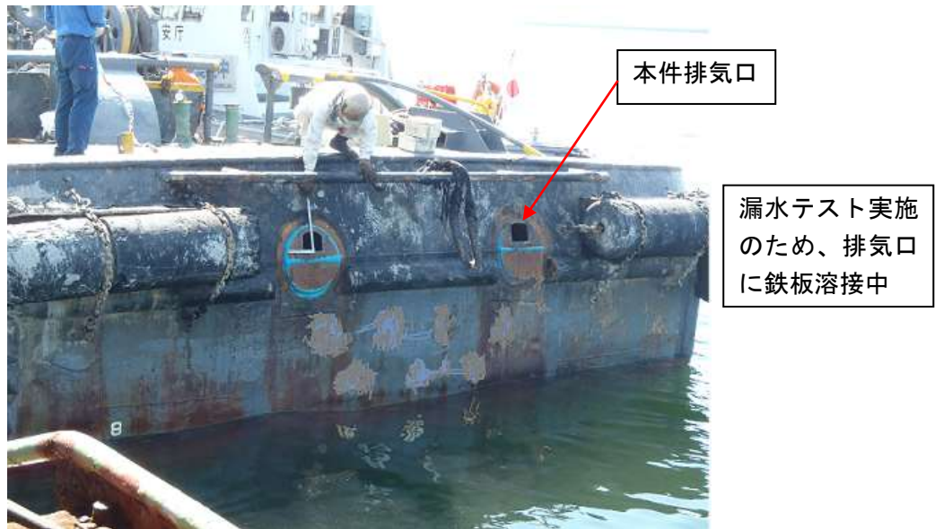
写真1 主機の排気口
