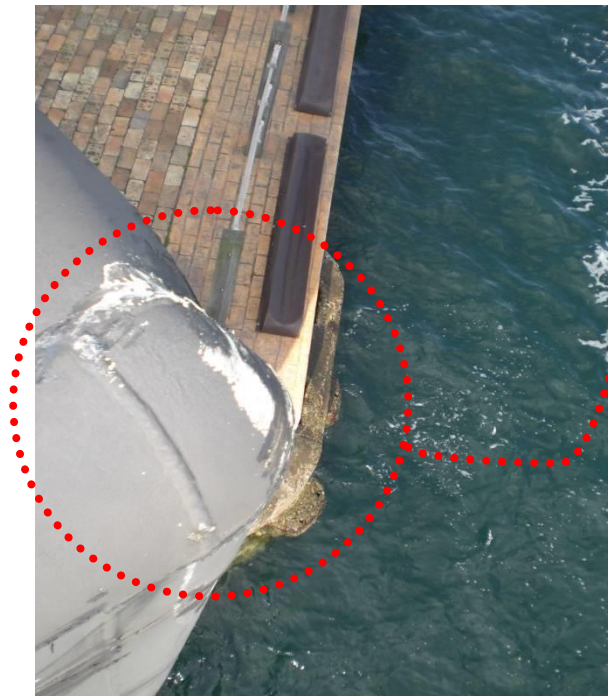
写真4 防舷材の損傷箇所
