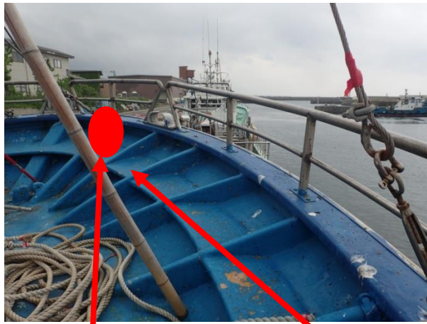
写真1 右舷船首部のブルワークの状況
