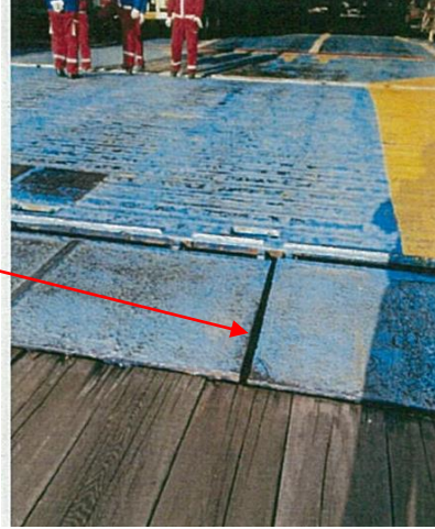
写真3 フラップ間の隙間の状況
