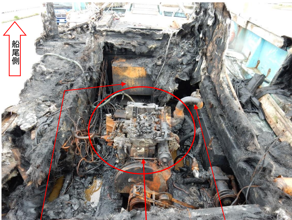
燃料油タンク
