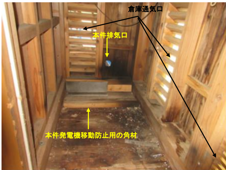
写真4 本件発電機移動後の本件倉庫
