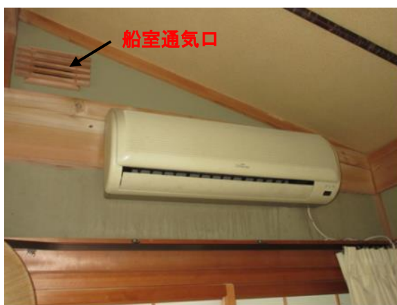
写真8 エアコン室内機及び船室用通気口
