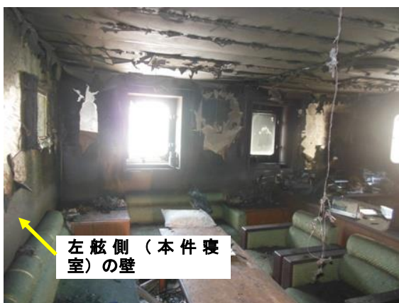
写真5 焼損した機関長室
