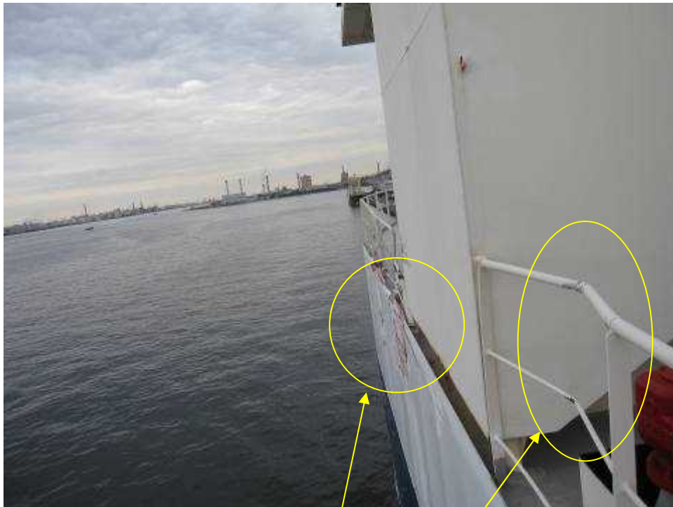
写真3 A船の損傷状況（左舷側外板その3）
