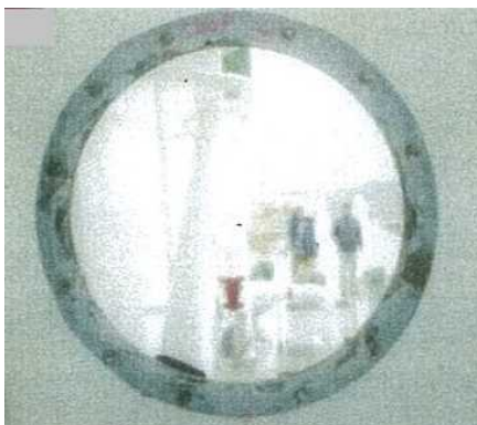
写真3 本件丸窓の脱落下の状況
