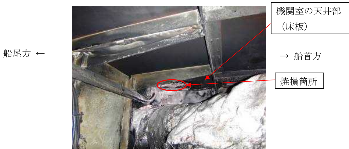
写真 2.1 - 3 機関室左舷船尾天井部焼損箇所
