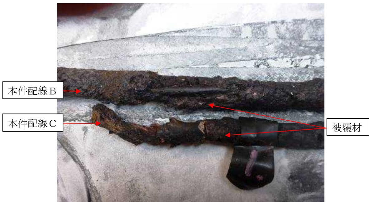
写真 2. 3 - 5 本件配線 B 及び本件配線 C の焼損状況
