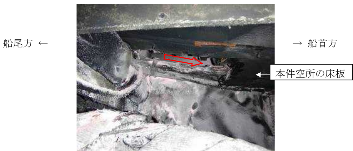
写真2.3-2 本件空所の床板の焼損状況 ( ← は焼けの方向を示す)
