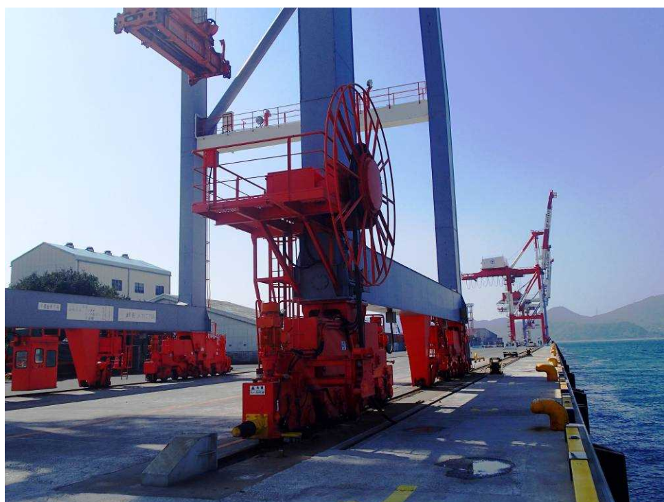
写真3 ケーブルリールの通常の状態（他のガントリークレーン）
