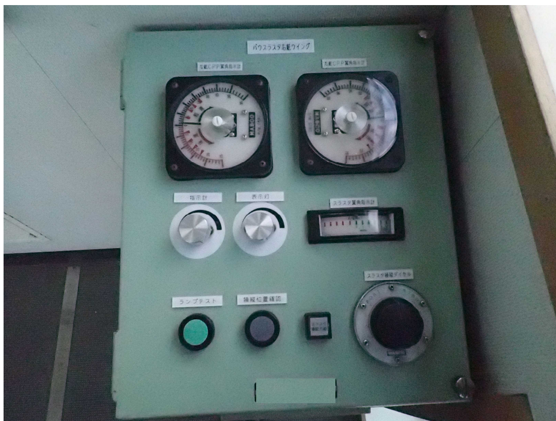
写真2 右舷ウイングのバウスラスタ操縦盤
