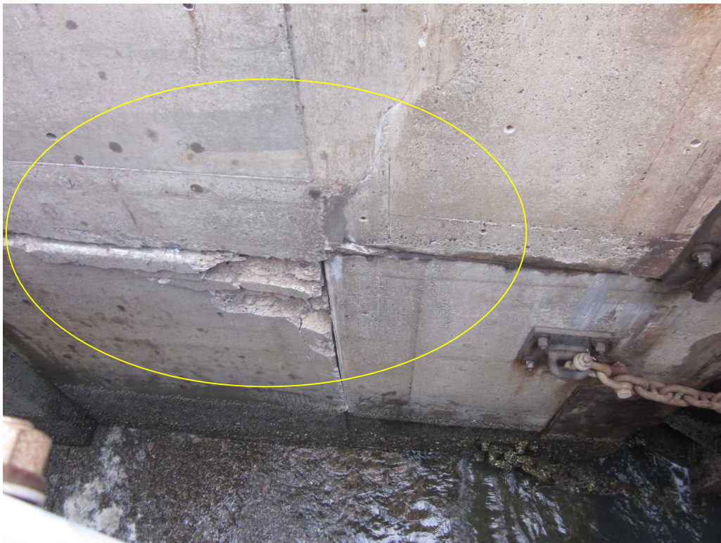
写真6 NO. 7防舷材コンクリートブロックの損傷状況①
