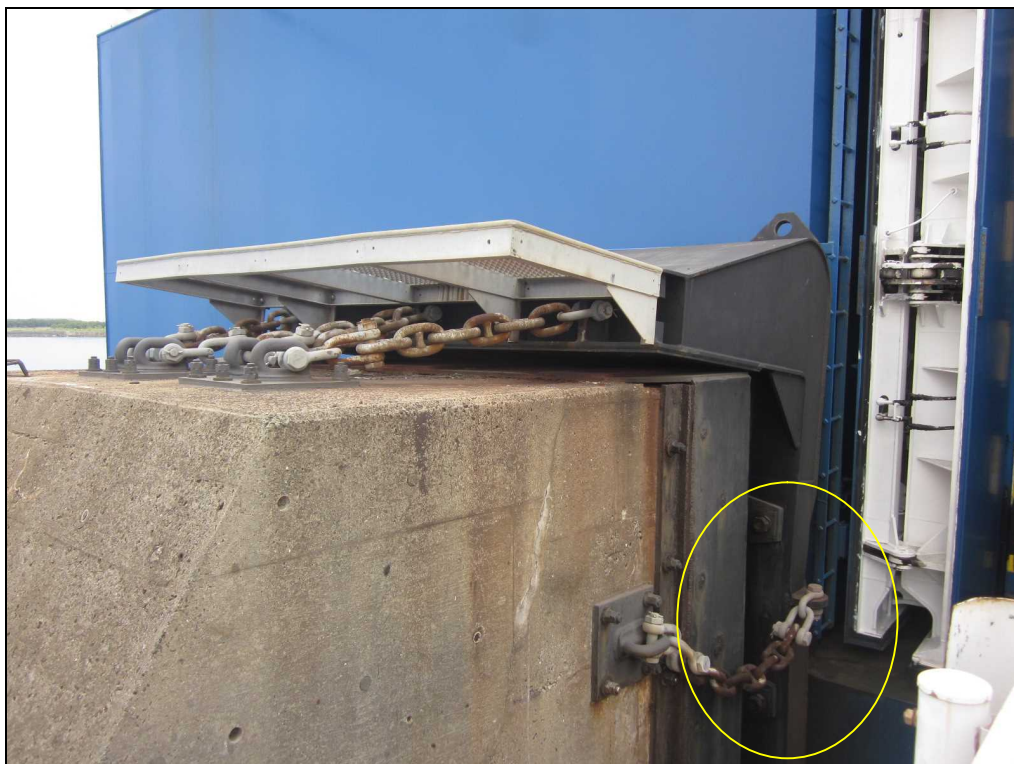
写真4 NO. 7 防舷材の損傷状況①
