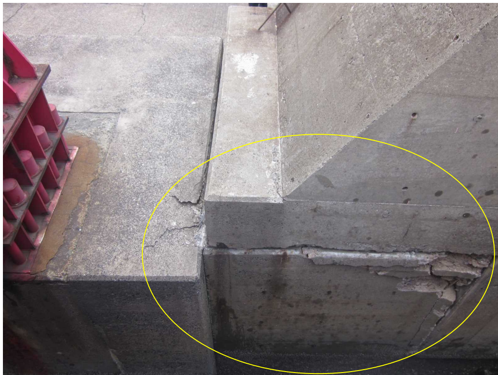
写真7 NO.7防舷材コンクリートブロックの損傷状況②
