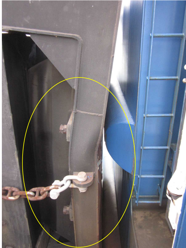
写真5 NO. 7防舷材の損傷状況②
