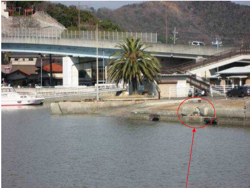
写真2 本件物揚岸壁の損傷状況
