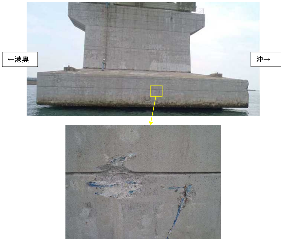
写真3 P5橋脚損傷状況
