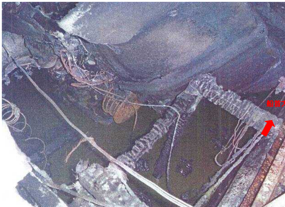
写真3 機関室右舷船尾側の焼損状況
