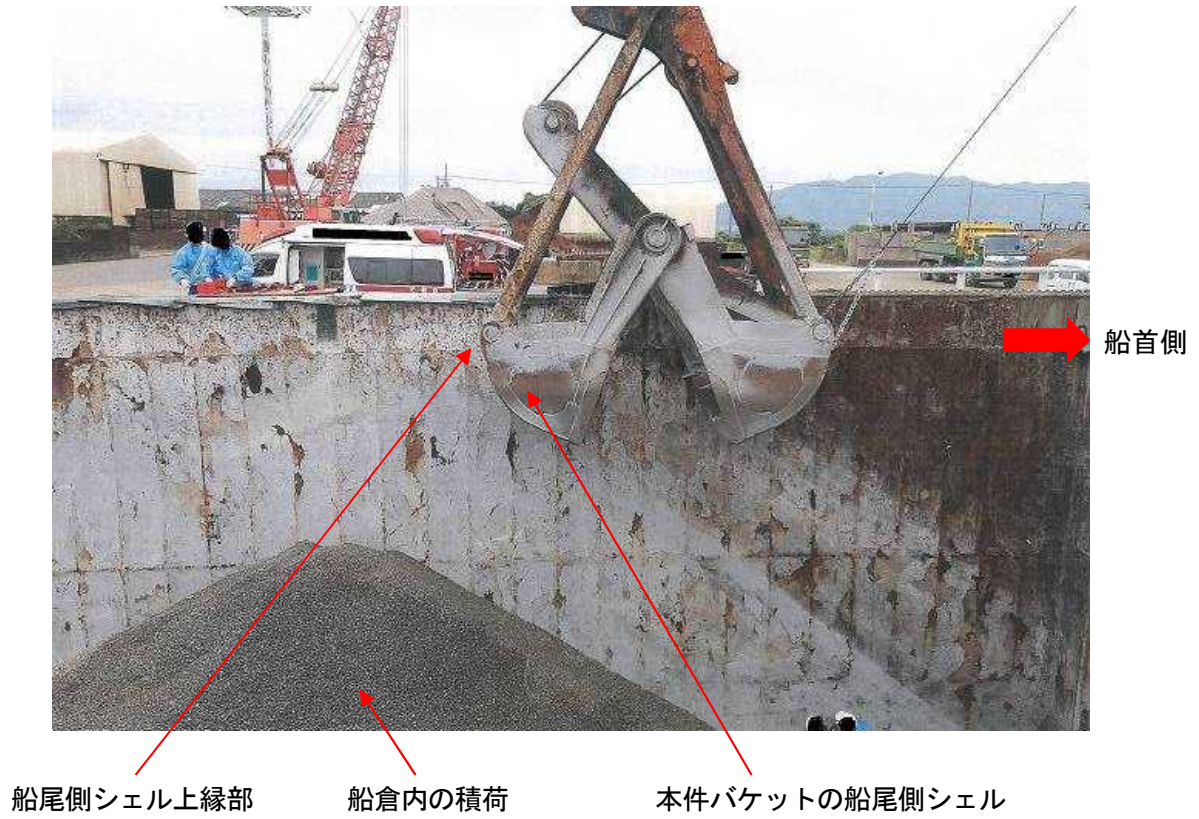
写真1 本事故発生時の本件バケットの状況
