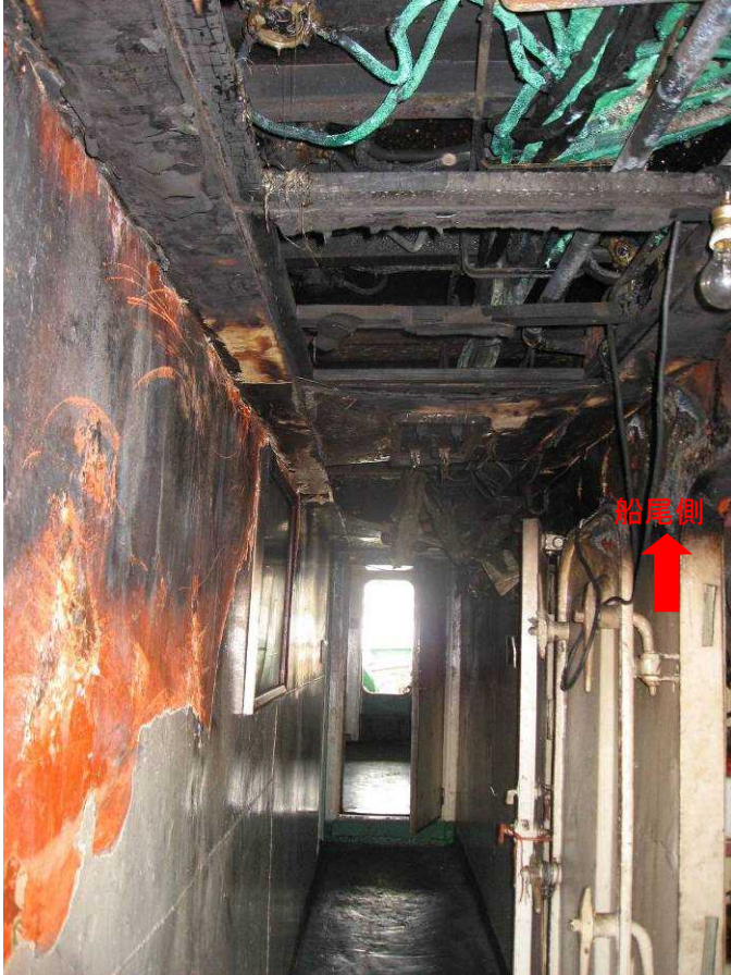
写真5 右舷側通路の焼損状況
