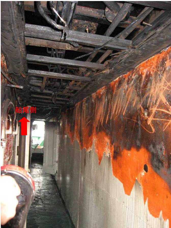
写真6 左舷側通路の焼損状況
