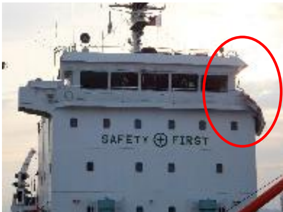
写真5 B船の船橋左舷ウイングの損傷状況①
