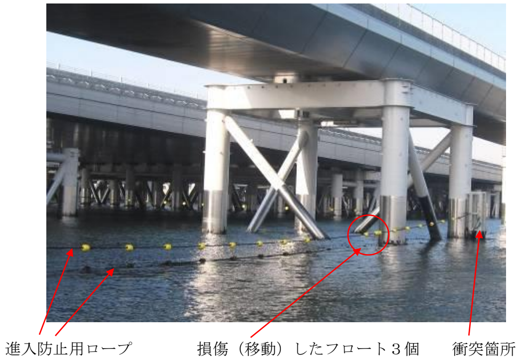
写真3 進入防止用ロープの損傷状況等
