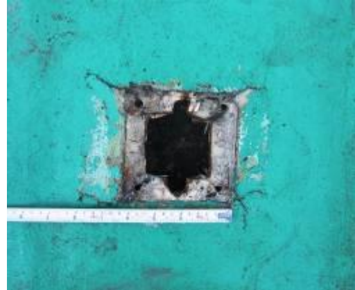
脱落した固定金具の跡
