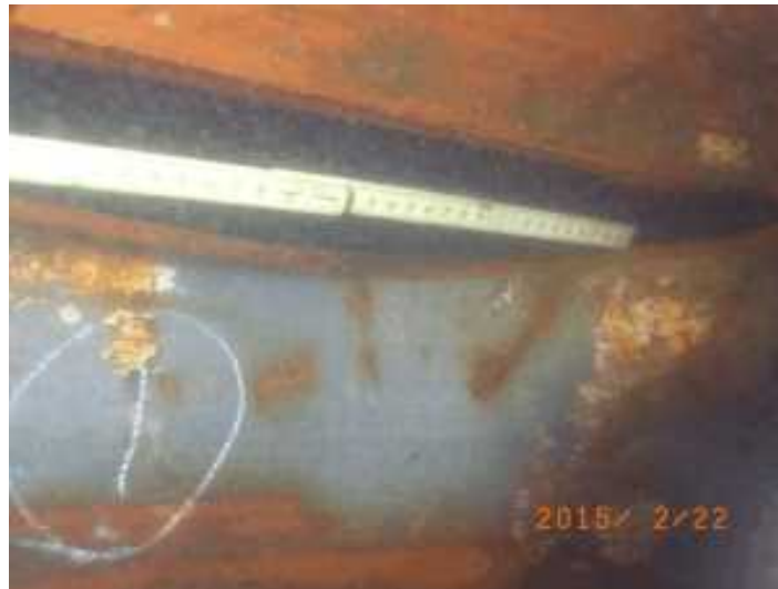
写真1 本船の損傷状況 (船底外板の左舷船首部破口)
