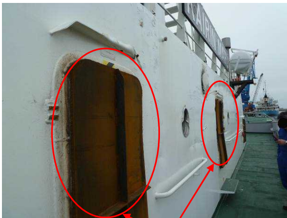
写真5 B船の甲板室左舷側の損傷状況
