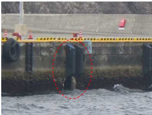
写真3 本件岸壁の損傷箇所
