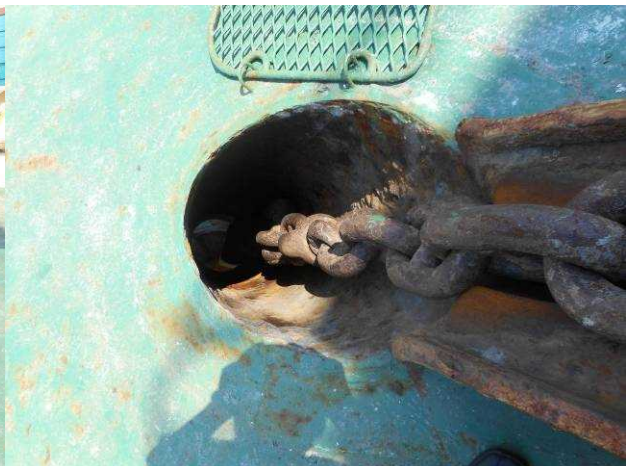
写真2 ホースパイプの状況
