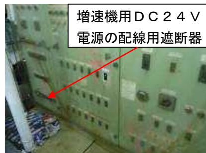
写真2 増速機用DC24V電源の配線用遮断器
