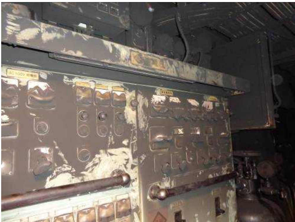
写真2 焼損した配電盤の状況
