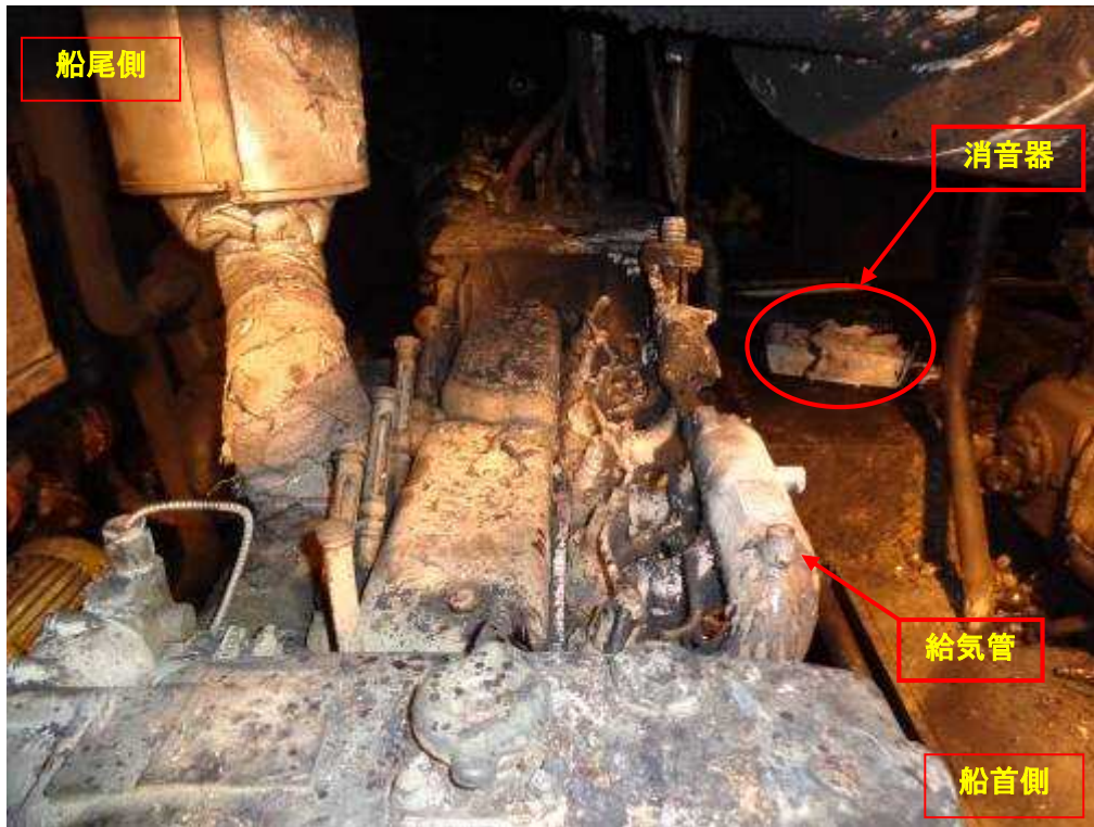
写真1 焼損した補機の状況
