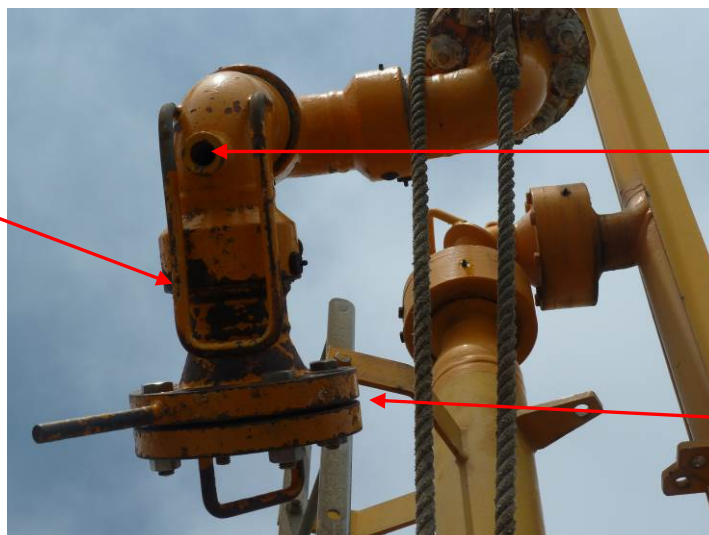
写真6 ベーパーライン先端部損傷状況
