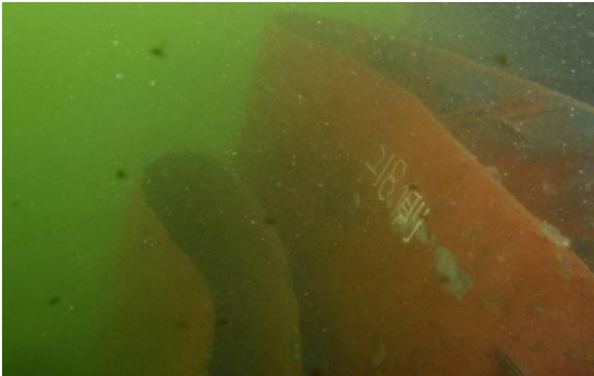
写真8 変形した鋼管の頂部
