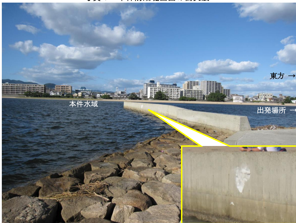
写真1 本件防潮堤西面の衝突痕
