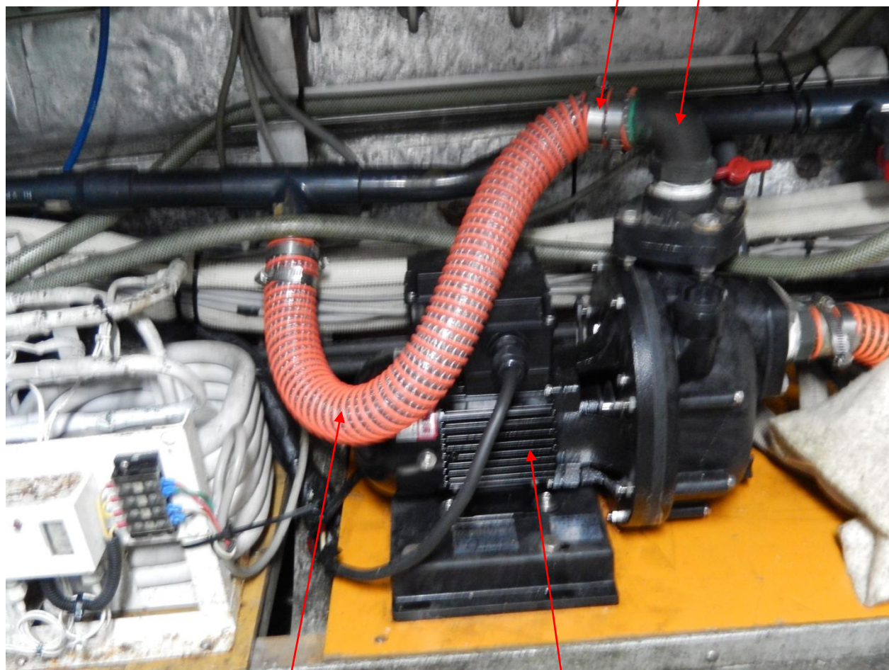
写真1 本事故後に新替えされた本件ポンプ及び本件ホース
