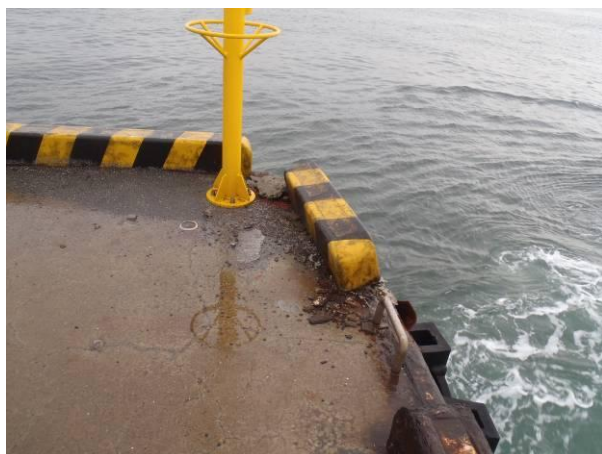
写真 3、4 本件岸壁の損傷写真
