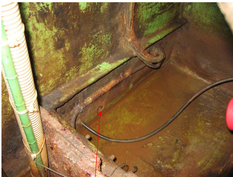
機関室へ通じる貫通孔
