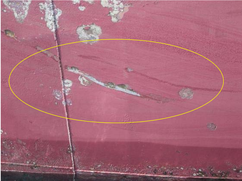
写真3 A船の損傷部位の状況
