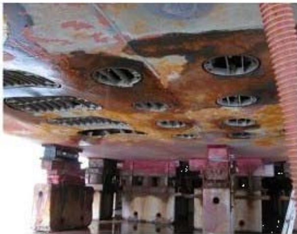
写真3 右舷前部船底部の損傷状況
