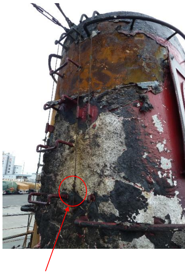
ダンパ付き空気抜き口が開口状態で固定
