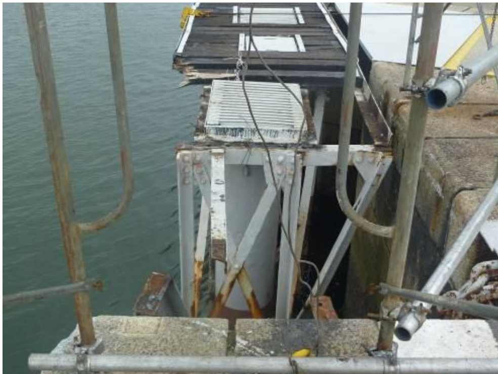
写真5 本件水門の左扉の破損状況
