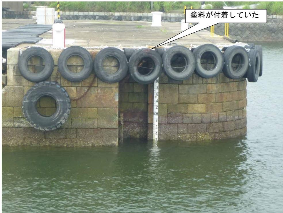
写真4 本件水門の右側壁の衝突箇所
