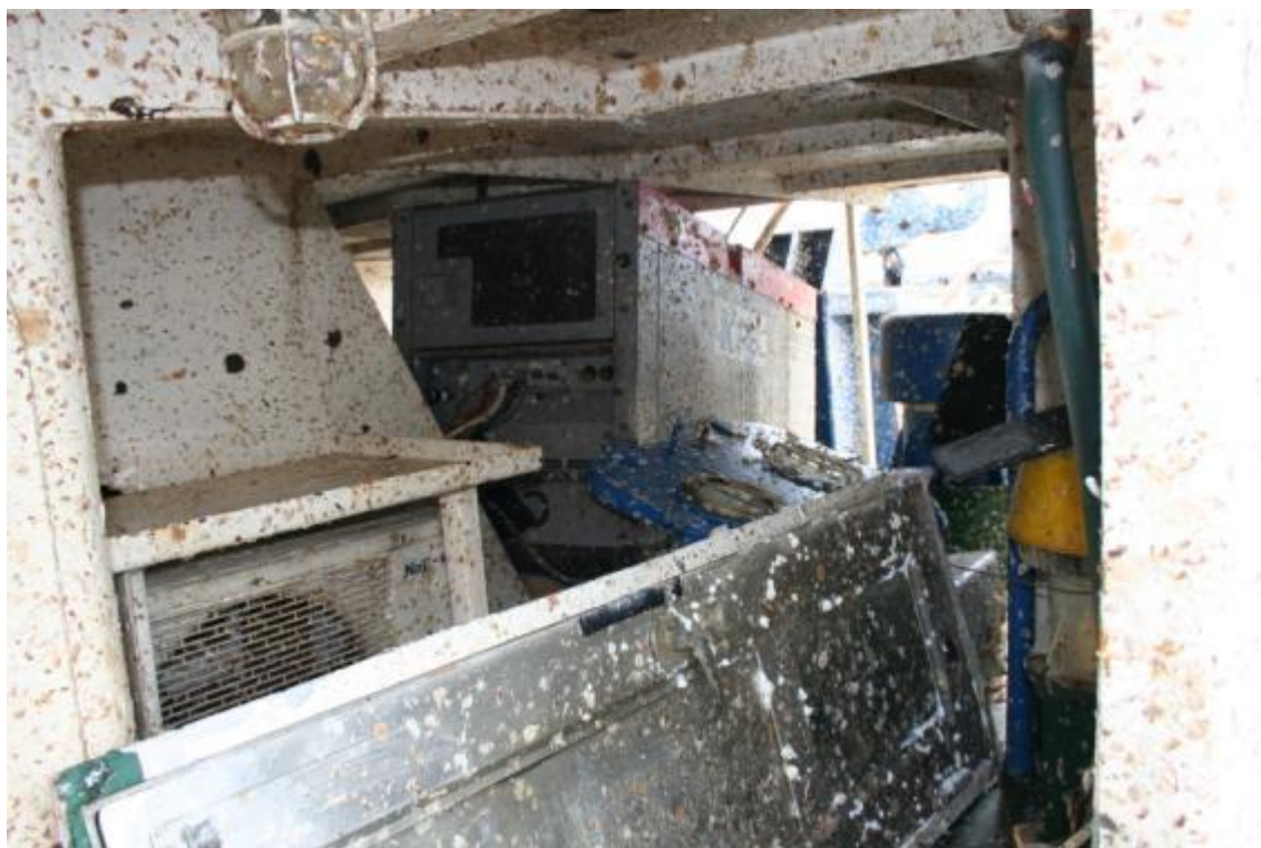
写真 9 搭載された発電機②
