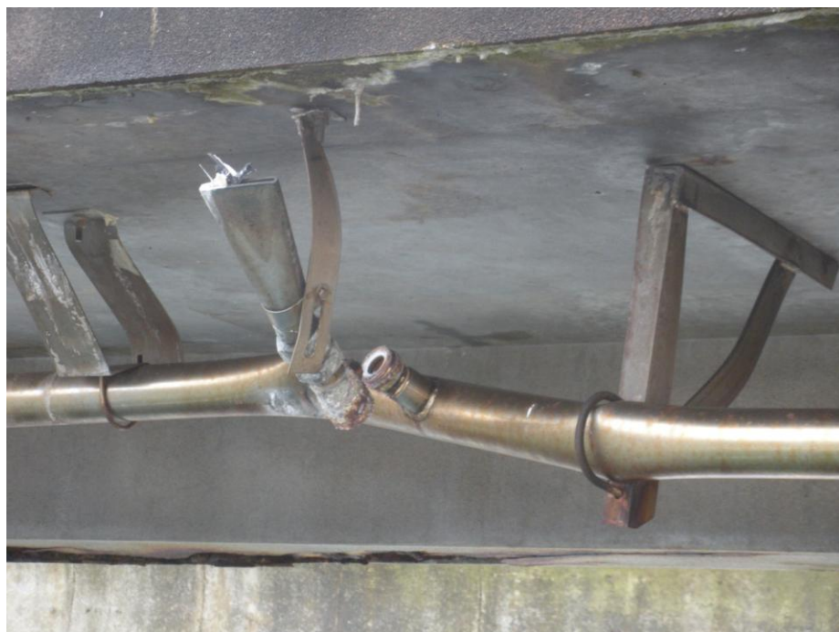
写真2 損傷した観覧通路床の海水噴出管
