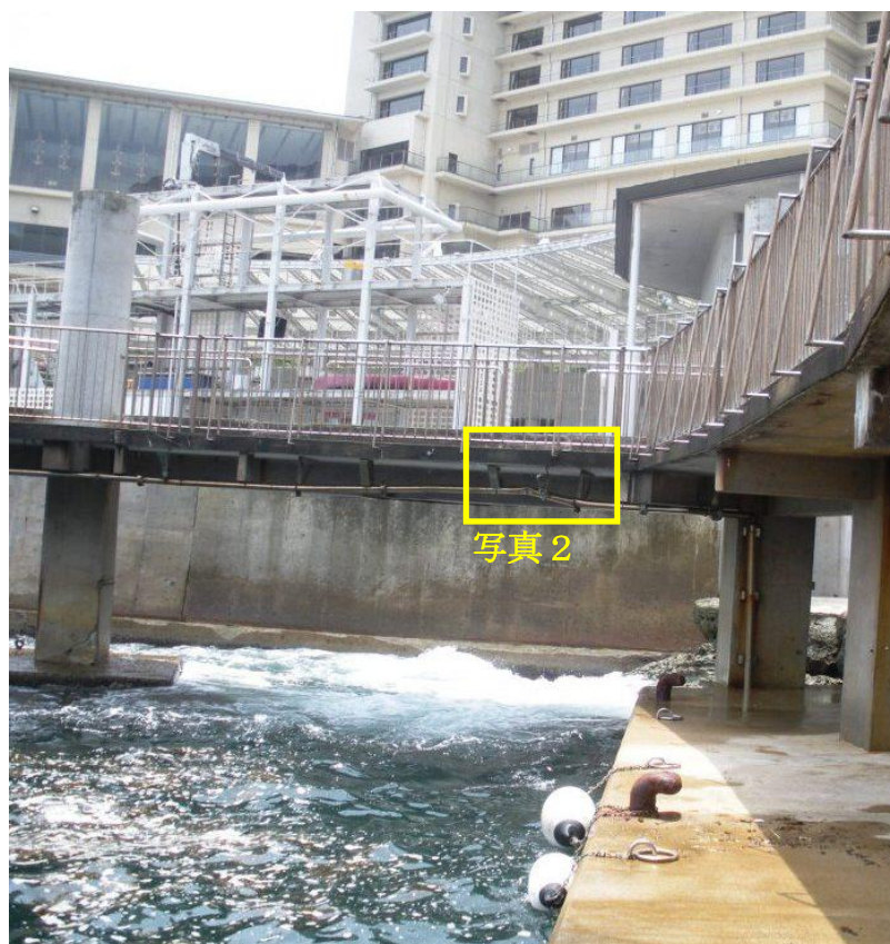
写真1 事故発生場所
