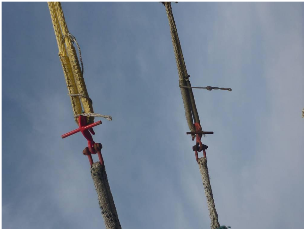
(岸壁側と船側の索の連結部分)
