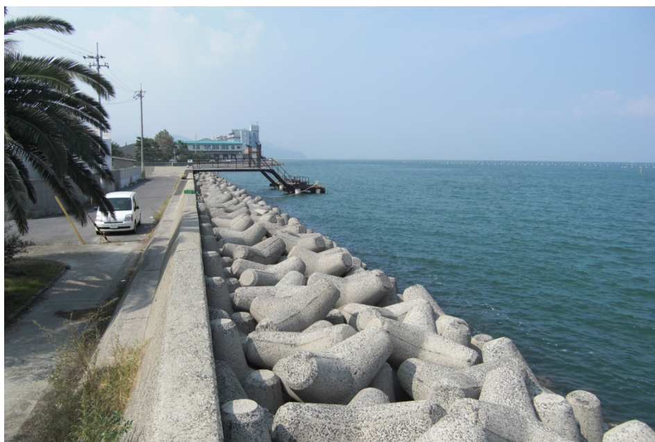
写真2 衝突した消波ブロック
