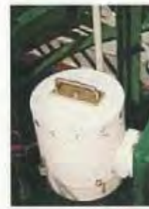
（消灯警報装置）
