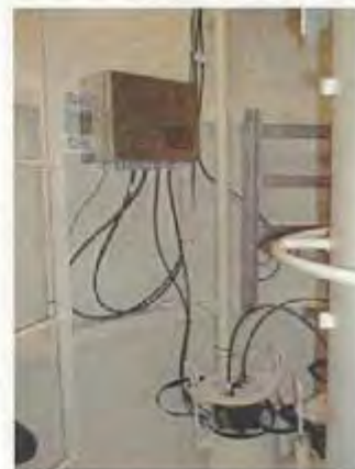
（制御装置・蓄電池）
